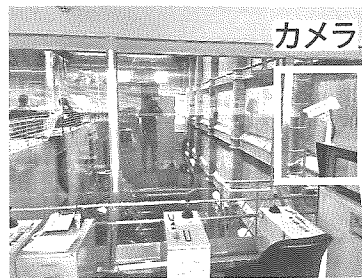
図3 設置状況（ごみピット）
